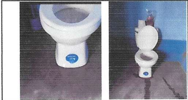
Foto 2: Las tazas de servicio sanitario presentan fugas tanto por asiento en el piso como en la unión del tanque con la tasa.
