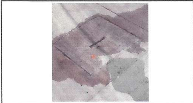
Foto 1: La limpieza de la fosa séptica es de suma importancia pues en repetidas ocasiones han rebalsado las aguas negras en las tapaderas de la fosa.
