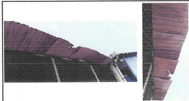
Foto 4: El área de recreación de los niños fue techada con lámina usada que hablan donado unos vecinos pero ya se encuentran dañadas y presentan filtraciones de agua cuando llueve y no hay ventilación por estar
