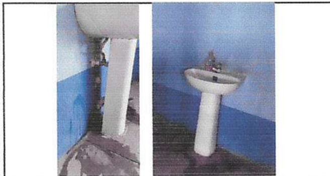
Foto 3: Todos los lavamanos desprenden mal olor quizá por una mala instalación, aparte también tienen fugas al momento de utilizarlos
